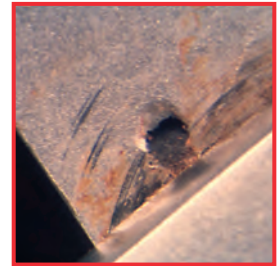
Delik korozyonu örneği
