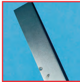
Delik korozyonu örneği
